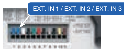
外部控制端口
